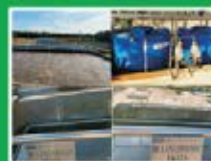
Hệ thống xử lý nước thải
